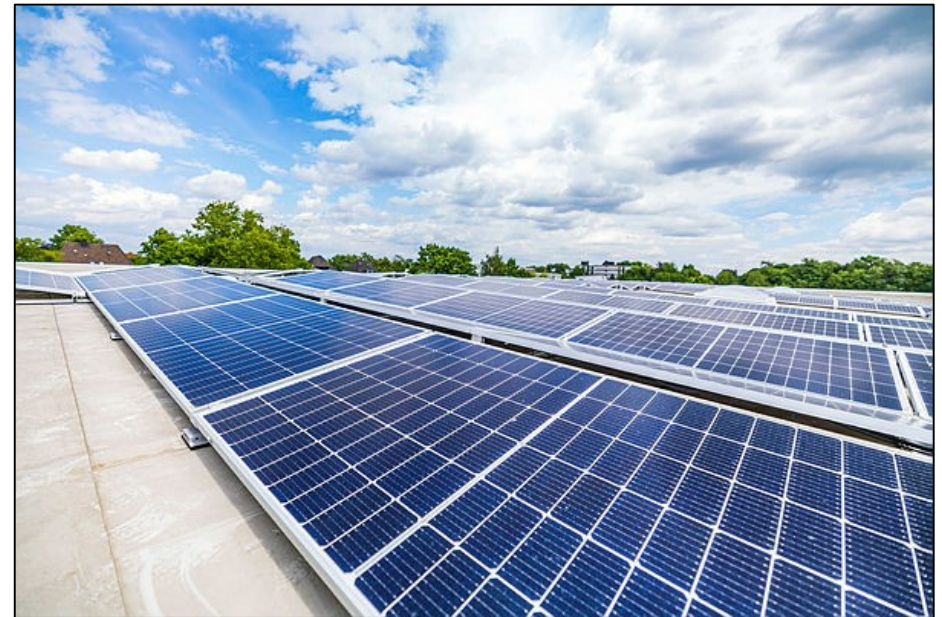
Abb. 24: Solaranlage (Beispielfoto) (© Thorsten Hübner, Stadt Hamm)
